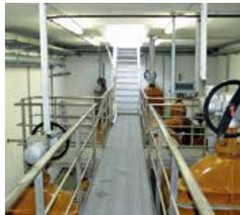
Mess- und Drosselschacht | © TBL
